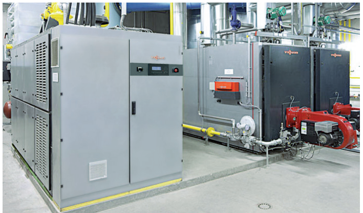
Blockheizkraftwerk (links) im Badeparadies Schwarzwald, zwei Vitoplex Kessel liefern bei Bedarf die Spitzenlast
