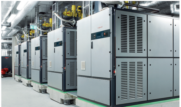
Fünf Vitobloc 200 Blockheizkraftwerke im Verwaltungsgebäude der Deutschen Gesetzlichen Unfallversicherung
