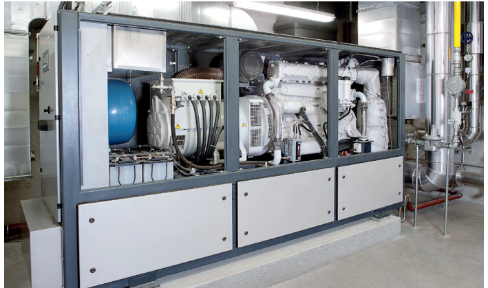
Vitobloc 200 EM-140/207 im St. Augustinus Krankenhaus in Düren
